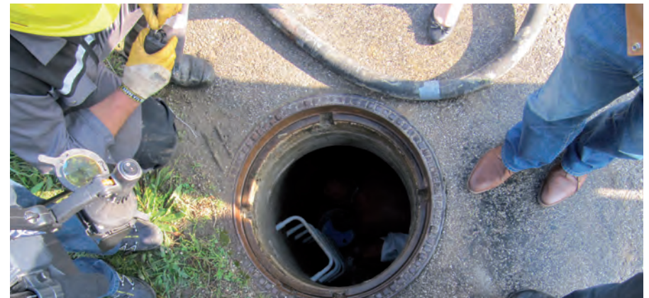
Leitungs-Informations-Systeme und Kanalsanierung
